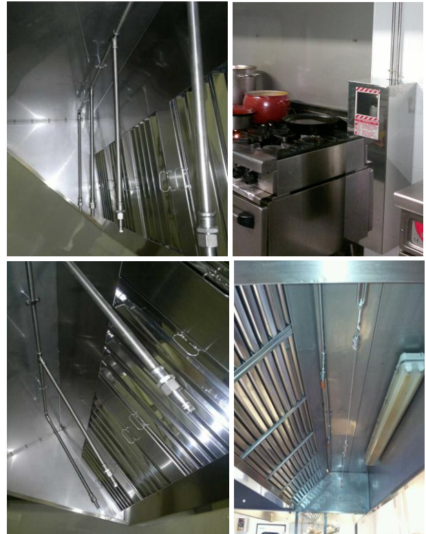
Armario y líneas del sistema CROCADES
