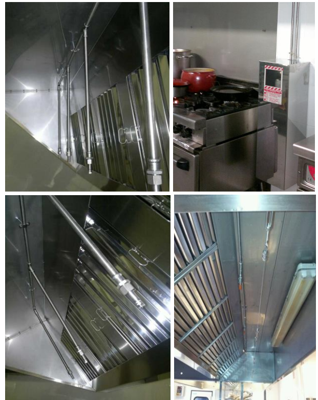
Fotos: Armario y líneas del sistema CROCADE.
